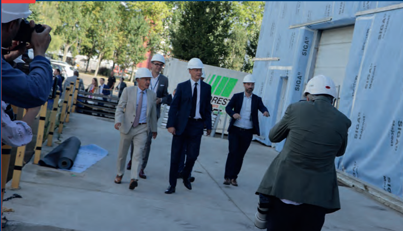
Visite du chantier de rénovation thermique. Le projet utilisera des matériaux biosourcés : isolation mixte avec fibres végétales, et bardage bois. Des nichoirs à oiseaux seront aussi installés.
